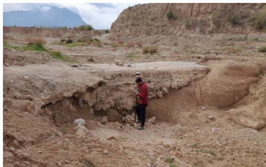
شکل ۲- آبستگي بستر رودخانه دوغ Fig. 2. Scouring of Dough River bed
